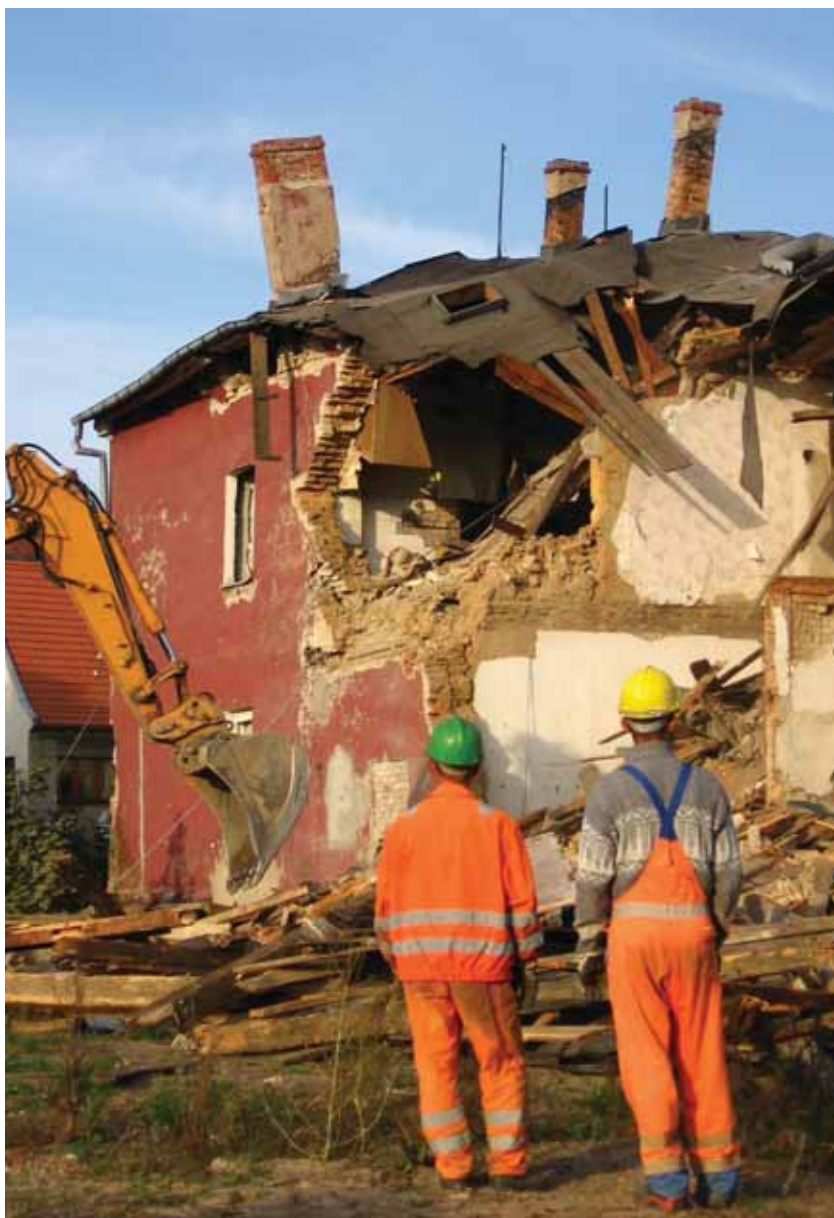
Asbestimäärus seab tööandjale kohustuse enne ehitise lammutamist, rekonstrueerimist, remonti või hooldust veenduda, kas see sisaldab asbesti või ei sisalda. Foto: Dreamstime
